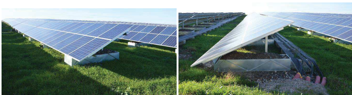
Photo 1 : Vues sur des longrines en gabion (source : QUADRAN, CET Saint-Jean-de-Libon, Hérault)
