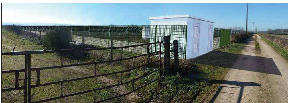
Illustrations du poste de livraison (QUADRAN)
