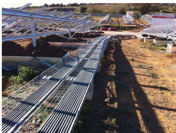
Photo 2 : Vue sur des câbles et leurs supports
